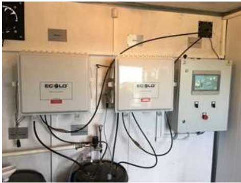
Насосная установка и блок управления АКНЗ
